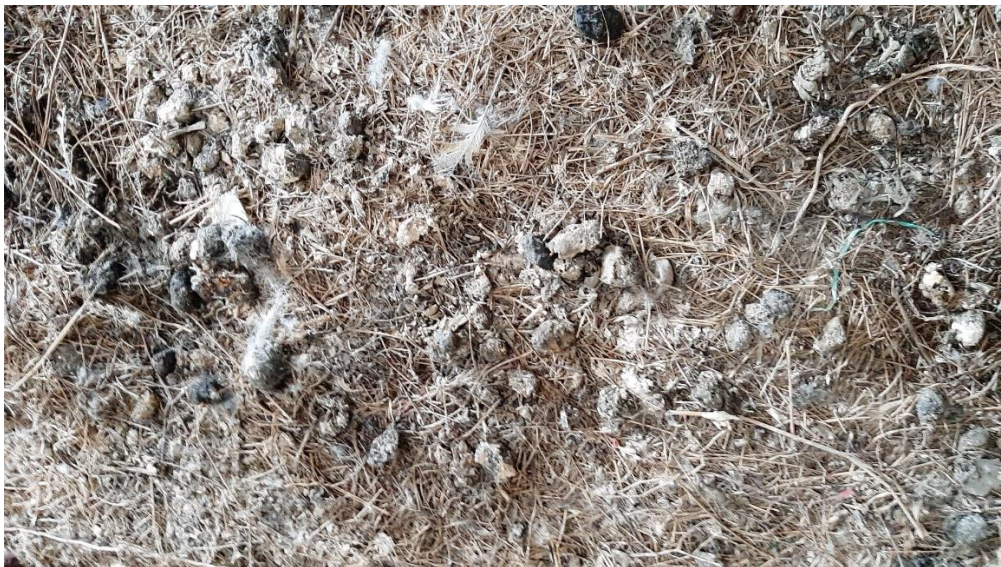
Figura 5 Pavimento del silo, ricoperto da borre
